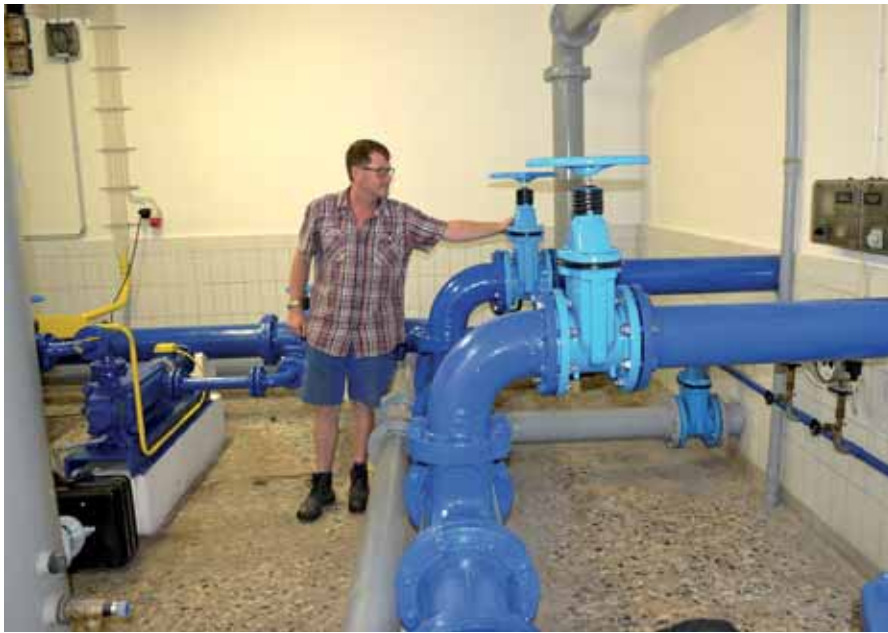
Bauhofleiter Dieter Hüttl, der auch der Wasserwart der Gemeinde ist, zeigt im Hochbehälter-Keller auf eines der ausgetauschten Absperrventile.
