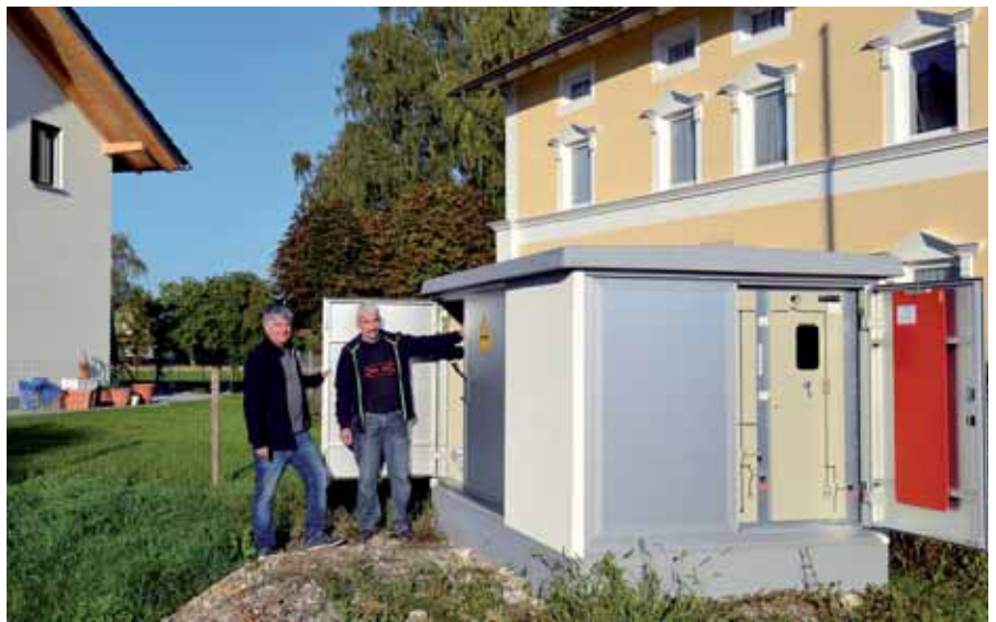
EGU-Vorstandsvorsitzender Josef Aicher und der für die EGU zuständige Elektromeister Adi Hager (links) an der im Vorjahr angeschafften Trafostation, die für das neue Baugebiet „An der Garchingener Straße“ notwendig wurde und die dort die Stromversorgungs-Sicherheit gewährleistet.
