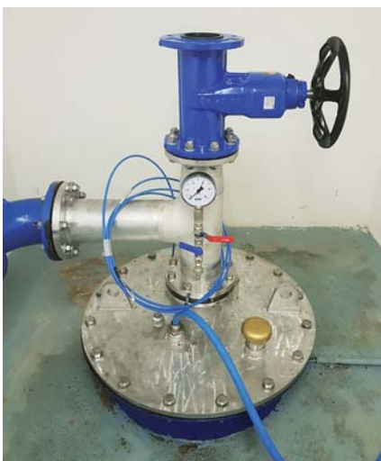
Der neue Pumpenkopf im Brunnenhaus-Keller.
