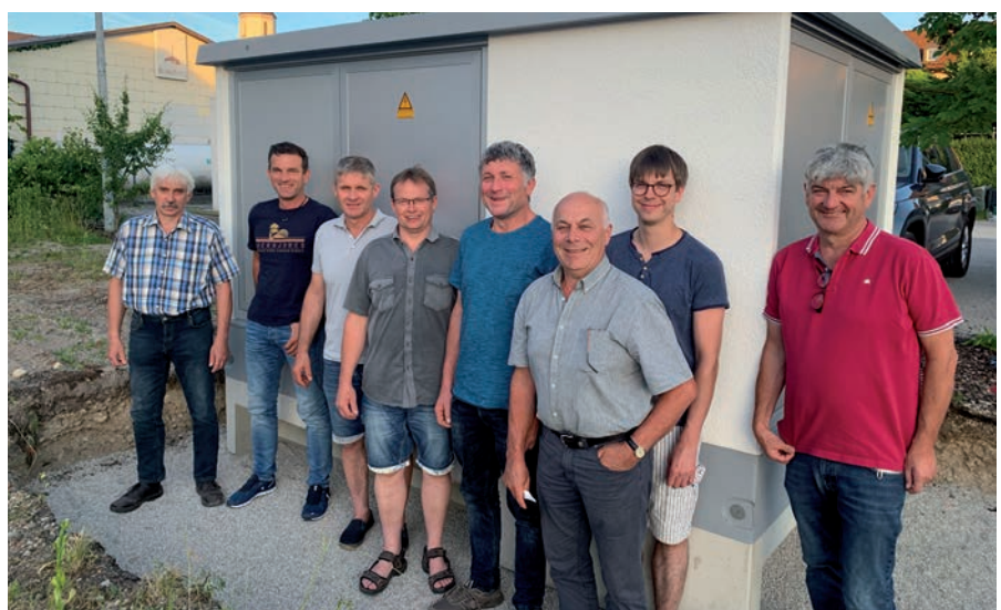
Aktueller Vorstand und Aufsichtsrat der Elektrizitätsgenossenschaft Unterneukirchen vor dem neuen Trafo Raspl. Von links nach rechts: 1. Vorstand Josef Aicher, Thomas Weinberger, Johann Reichenspurner, Günther Kurz, Andreas Schwanthaler, Josef Kainzmaier, Erich Zwirgmaier, Elektromeister Adolf Hager.
