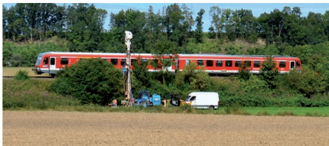
Die Bodenbeschaffenheit an der Bahnlinie im Bereich unserer Gemeinde in Moos wurde im Sommer durch Probebohrungen untersucht.
