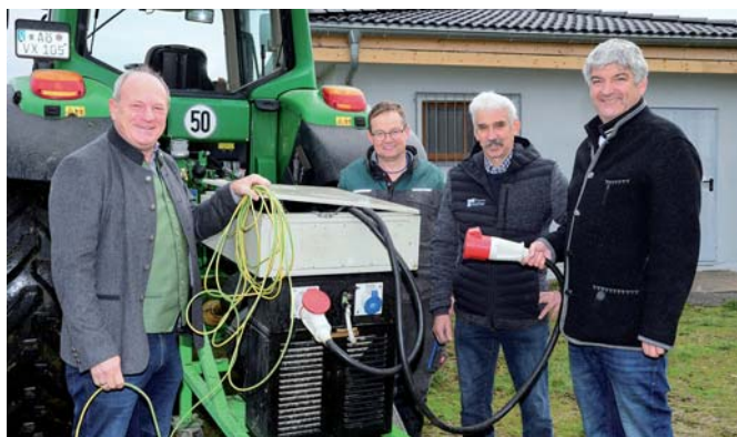
Das Notstromaggregat wird am Brunnen getestet.
